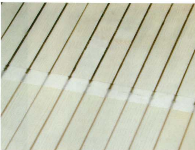
Im oberen Bereich ist eine deutliche Verfärbung eines 1K-Wassersiegels zu erkennen. Im unteren Bereich zeigt ein zweikomponentiger Wasserlack nur vergleichsweise geringe Verfärbungen.
