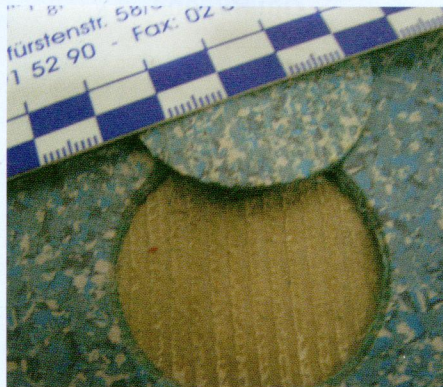
Eine geöffnete handtellergröße, kreisrunde Blase in einem Kautschuk-Bodenbelag auf Grund ungenügender Klebstoffbenetzung und Überschreitung der Ablüftezeit.
