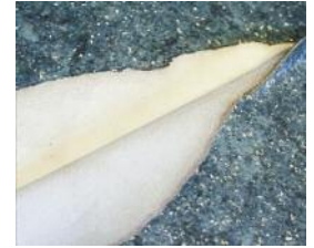
Delaminierung nach Überbeanspruchung durch Stuhlrollen
