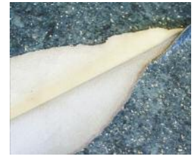
Delaminierung nach Überbeanspruchung durch Stuhlrollen
