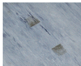
Verfärbung und Eindrücke durch ungeeignete Rollen
