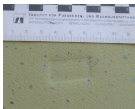
Schadensbild durch scharfkantigen Möbelfuß
