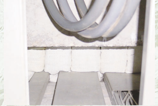
Asbestkissen zur Brandabschottung
