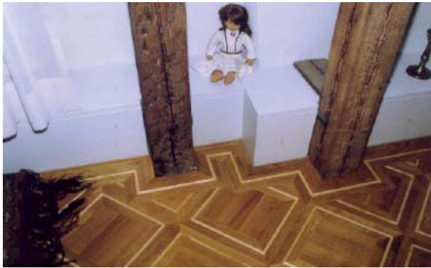
Anschluss zu Wand mit Kittfugen anstelle von Sockelleisten
