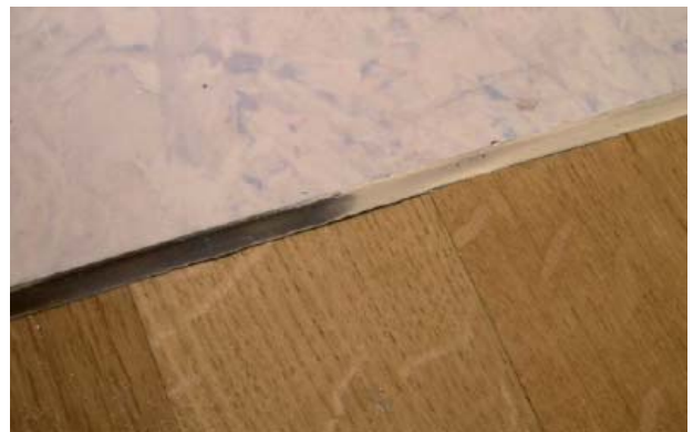
Kittfuge vor und nach der Reinigung
