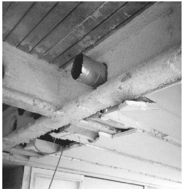
Spritzasbest an einer metallischen Tragkonstruktion, IST
