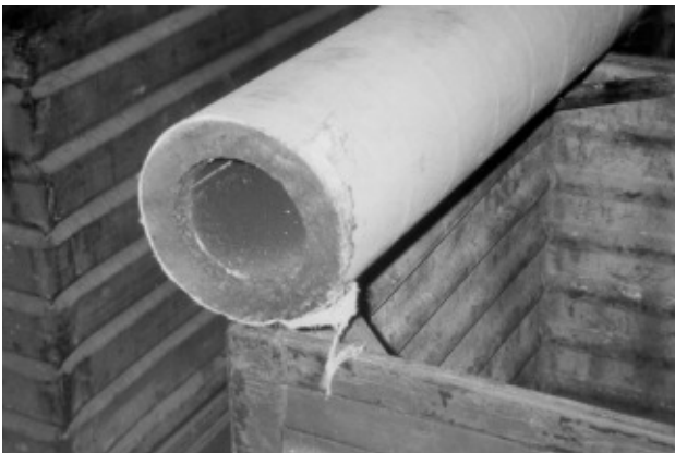
Asbesthaltige Rohrisolation, Foto IST
