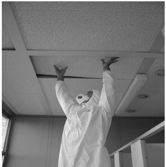
Asbesthaltige, abgehängte Deckenplatte (Akustikplatte), IST
