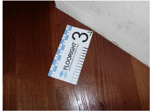
Zu geringer Wandabstand (Für den Schaden nicht relevant).
