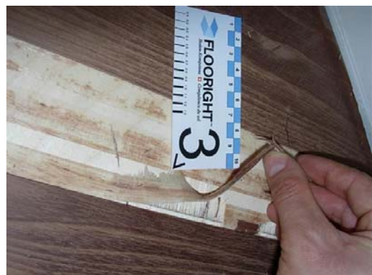
Decklamellenkleber haftet hautähnlich an der Trägerschicht (sehr schlechte Verbindung).
