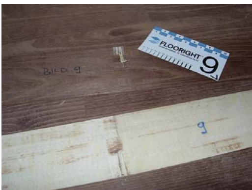
Abgelöste Decklamellen vom Trägermaterial.
