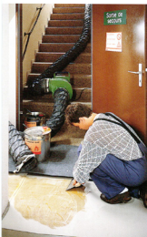
Bild 1: Auftragen eines lösemittelhaltigen Klebstoffes in einem Kellergeschoss vor dem Verlegen des Bodenbelages. Absaugschlauch und explosionsgeschützter Ventilator.
