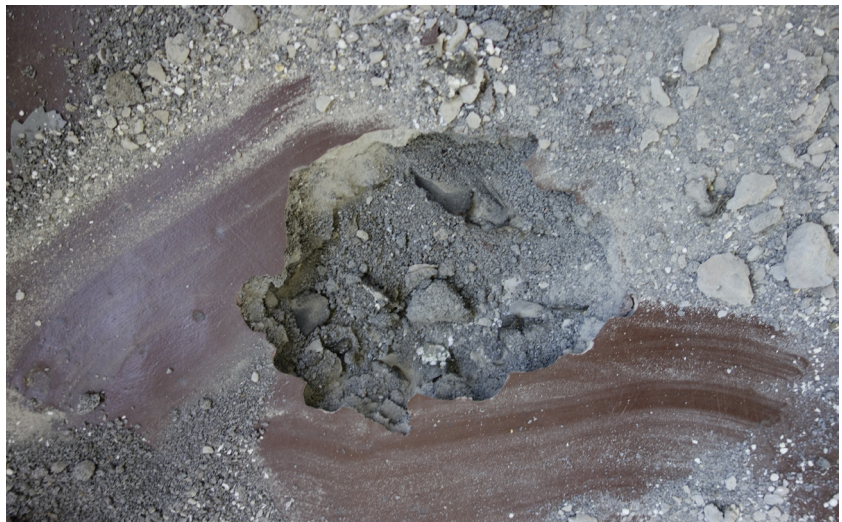
Dieser Schlackeestrich ist nicht mehr tragfähig, wie man bereits augenscheinlich erkennen kann, Bilder: Wolfram Steinhäuser
