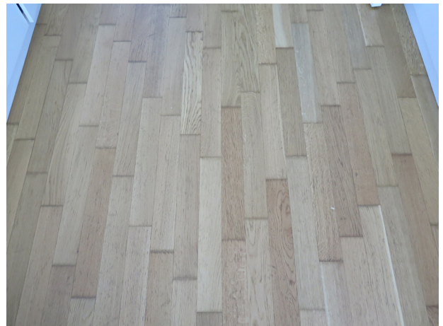
Eichenfertigparkett mit Verfärbungen stirnseitig
