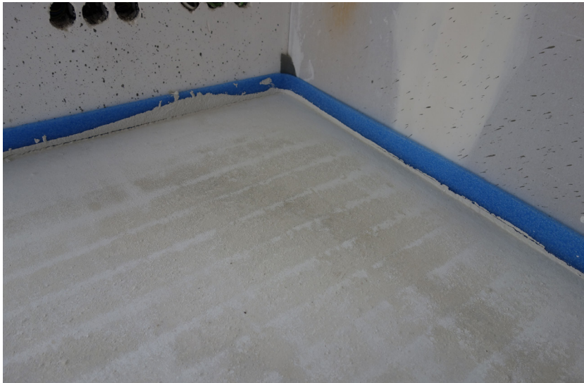
Sinterschicht auf der Estrichoberfläche
