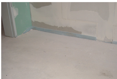
Nicht fachgerecht eingebauter Randdämmstreifen
