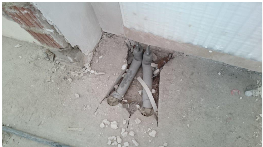
Mangelhaft eingebaute Heizungsrohre
