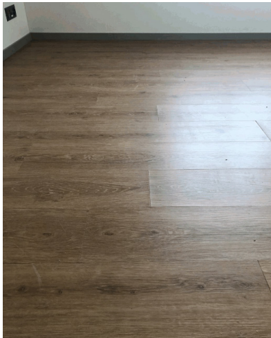
Beispiel von Stippnaht und offener Fuge aufgrund von falscher Akklimatisation
