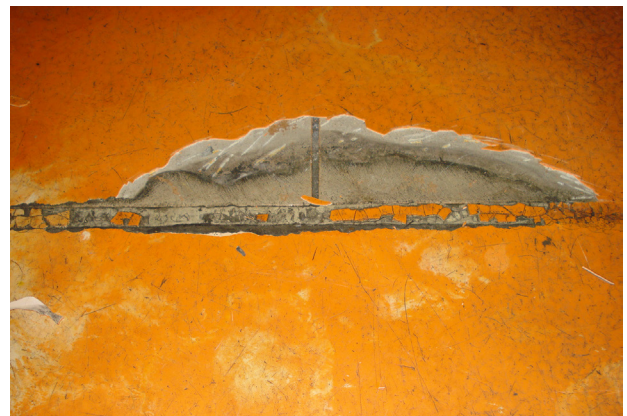
Fehlstelle in einer alten Epoxidharzbeschichtung
