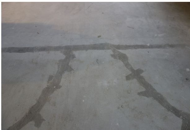
Risse im Estrich müssen fachgerecht verharzt werden
