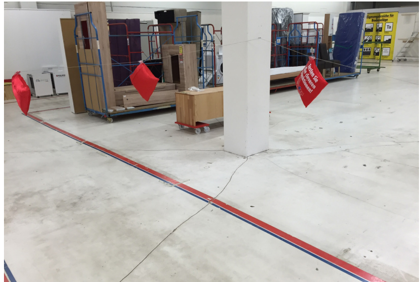
Risse im Betonuntergrund
