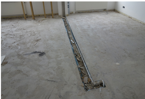
Diese Fehlstelle im neuen Calciumsulfatestrich entstand nach dem Entfernen einer Trockenwand
