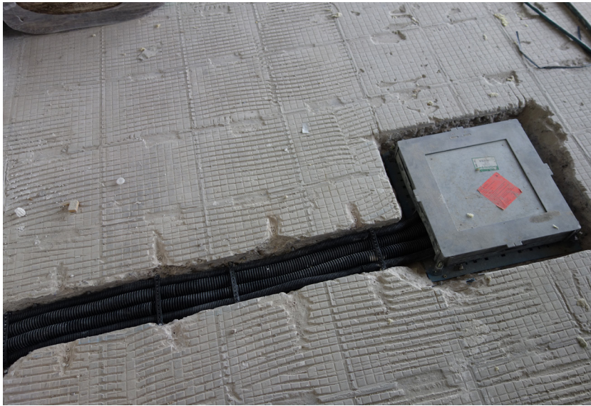
Diese Fehlstellen werden i.d.R. mit einem Reaktionsharzmörtel geschlossen, ist aufgrund der geringen Überdeckung problematisch
