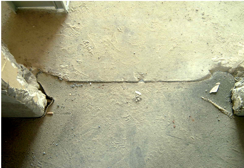
Nicht fachgerecht geschlossene Fehlstelle mit einem Gussasphalt
