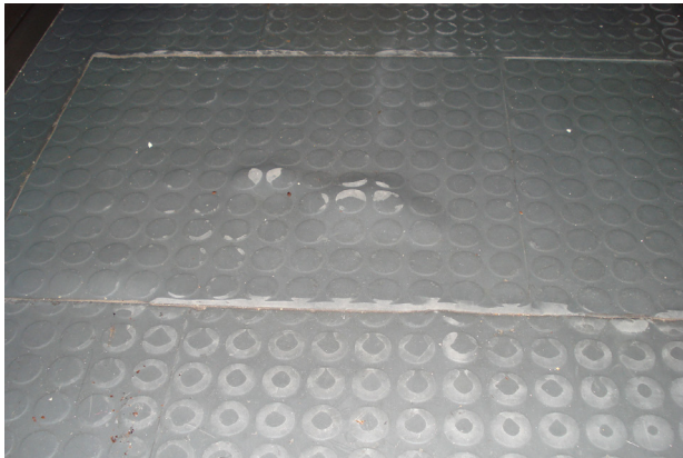
Blasen und Beulen sowie offene Nähte im Kautschukbelag. / Bild: Wolfram Steinhäuser
