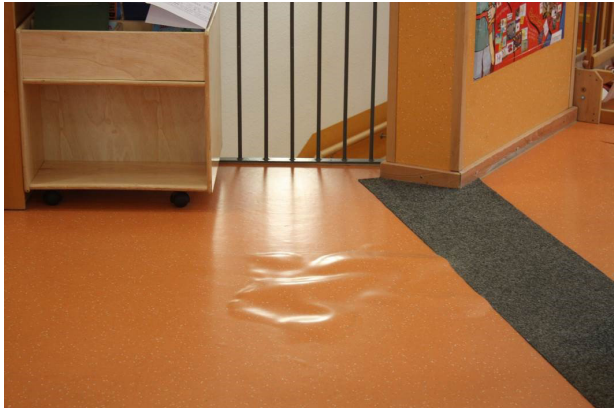
Blase im Linoleumbelag durch partiellen Wassereintritt in den Alt-estrich
