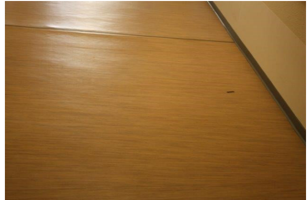
Stippnagt aufgrund nicht ausreichender Klimatisierung des Linoleumbelages
