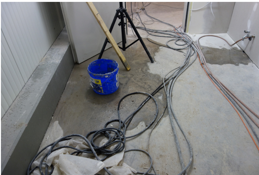
Nachträglich eingedrungene Feuchte durch Vorgewerke verursacht Blasen und Beulen im elastischen Bodenbelag
