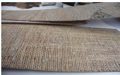
Zu geringer Klebstoffauftrag auf den Lino-leumbelagumbelages
