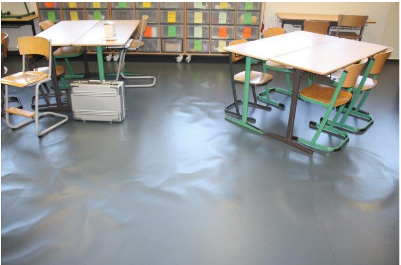
Blasen und Beulen im PVC-Belag aufgrund des zu feuchten Zementstrichs, Bilder: Wolfram Steinhäuser
