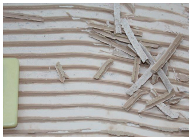
Stehende Klebstoffriefen aufgrund zu späten Belageinlegens und fehlendem Anwalzen des PVC-Belages
