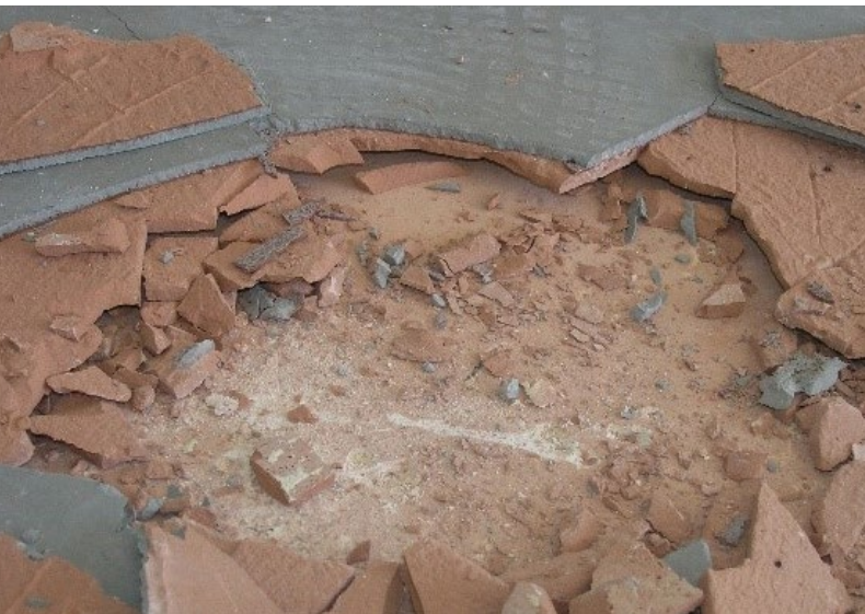
Der DDR-Anhydrit wurde durch die Trocknungsspannungen der neu aufgetragenen zementären Spachtelmasse regelrecht zerrissen
