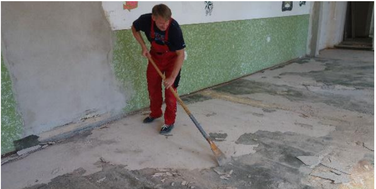
Die abgeplatzte Spachtelmasse wurde mit einem Schaber restlos entfernt
