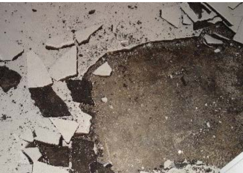
Abgeplatzte Spachtelmasse von einem nicht fachgerecht abgequarzten Gussasphaltestrich
