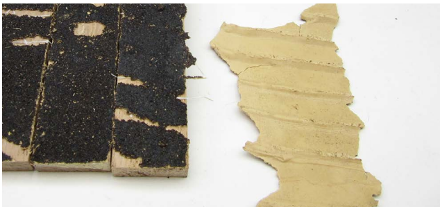
An der Rückseite der Parkettstäbe befindet sich der labile Gussasphaltestrich
