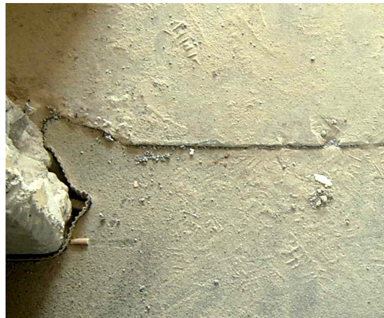
Der neu eingebaute Gussasphaltestrich wurde nicht fachgerecht an den vorhandenen Anhydriestrich eingebaut
