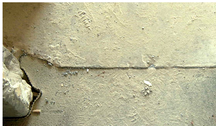
La nouvelle chape d'asphalte coulé n'a pas été posée dans les règles de l'art contre la chape anhydrite existante
