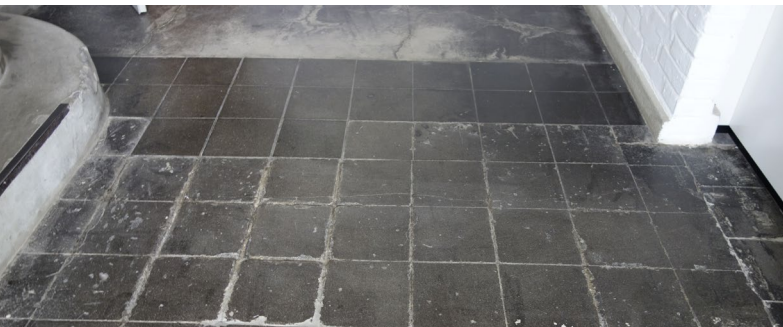
Plaques d'asphalte compacté dans les toilettes du musée du Bauhaus à Dessau
