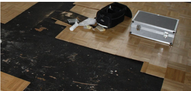
Le parquet s'est détaché de la chape d'asphalte coulé non quartzée
