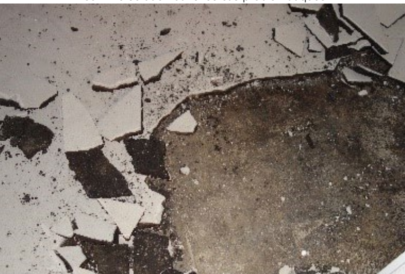
Enduit écaillé d'une chape d'asphalte coulé qui n'a pas été quartzée dans les règles de l'art
