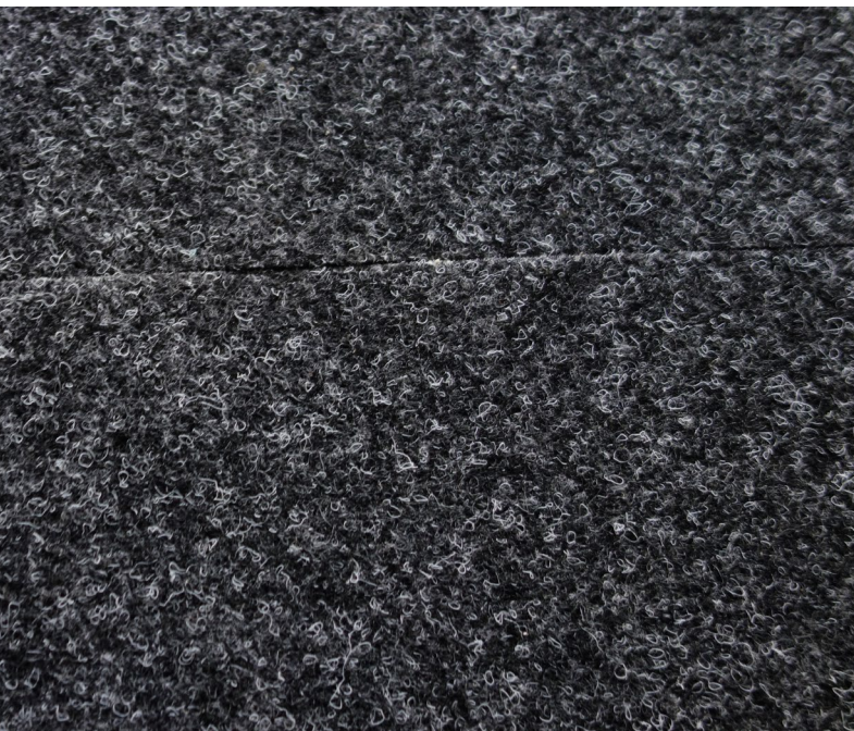
Joint visible dans le revêtement aiguilleté
