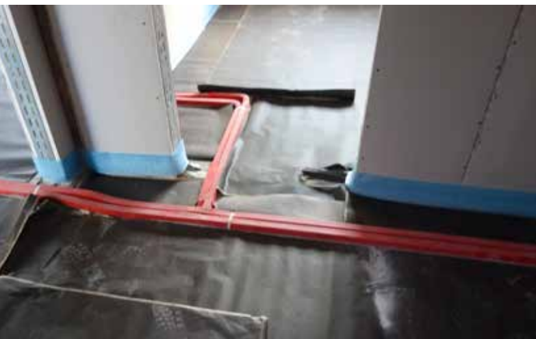
Lors de la pose de chapes sèches sur ces supports, un remblai de nivellement est absolument nécessaire
