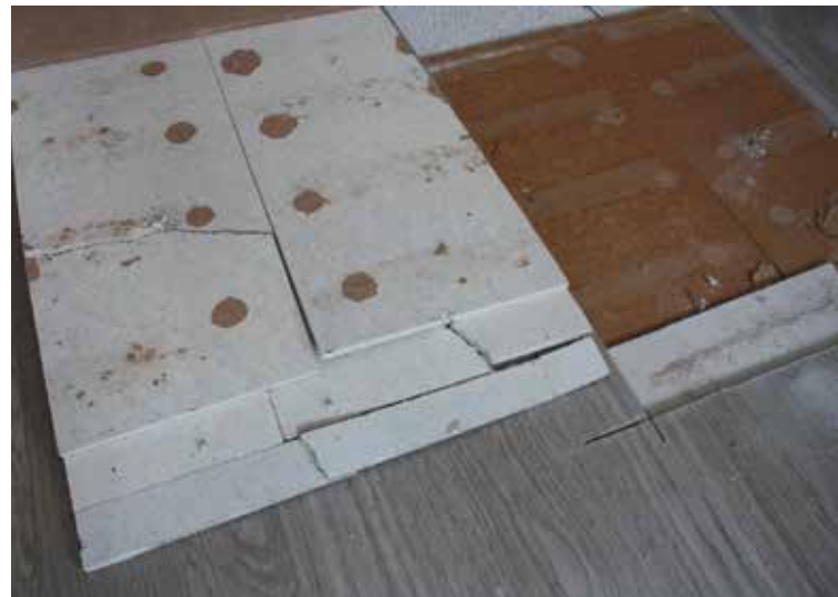
La chape sèche mal posée a dû être entièrement retirée
