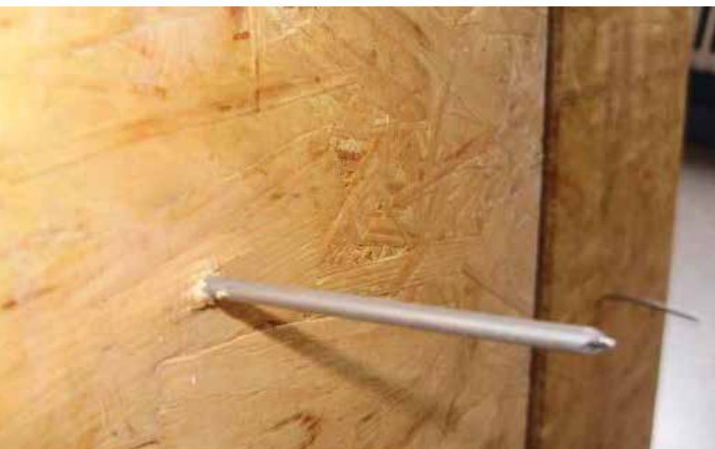
Élément de fixation inadapté lors de la pose de panneaux OSB sur un plancher
