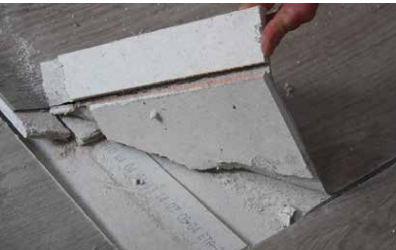
La chape sèche s'est affaissée et s'est cassée
